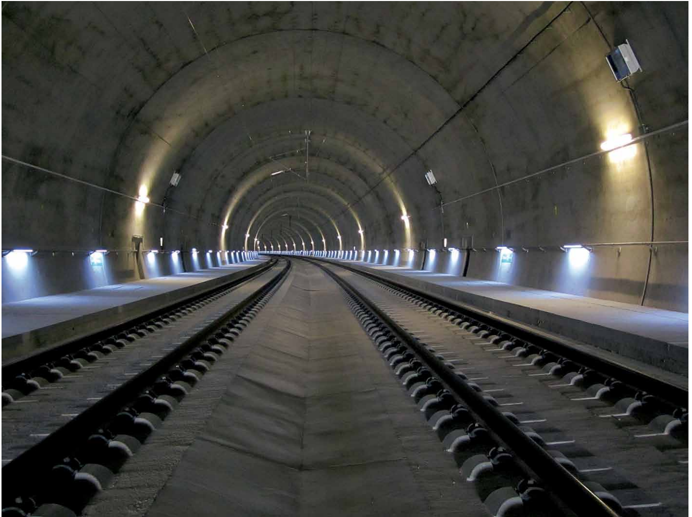
Pevná jazdná dráha v tuneli Turecký vrch Solid track in tunnel Turecký vrch
